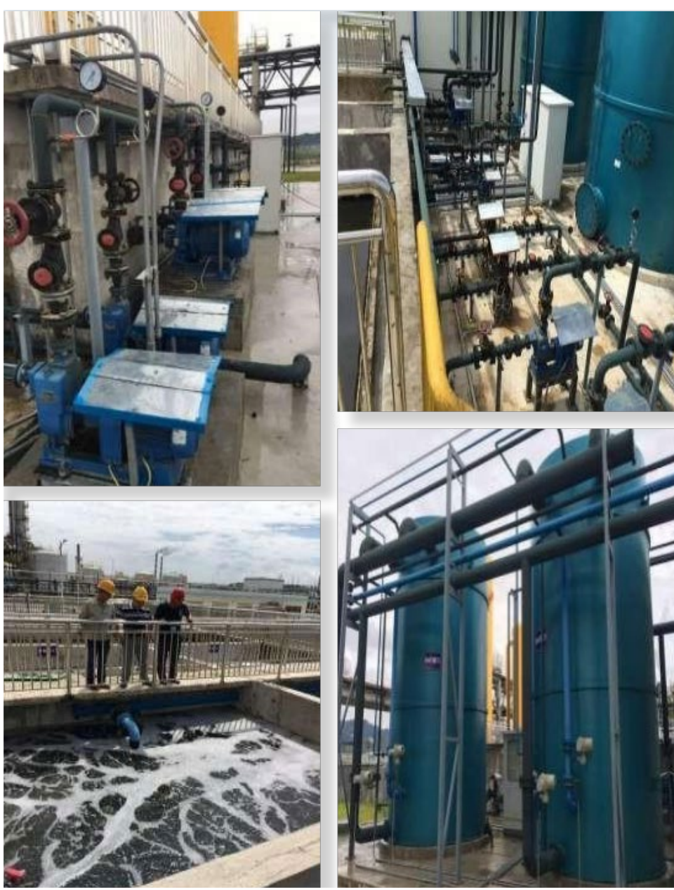
化工企业 18.5 万吨 / 年表面活性剂 及炼油助剂项目生产废水处理工程
