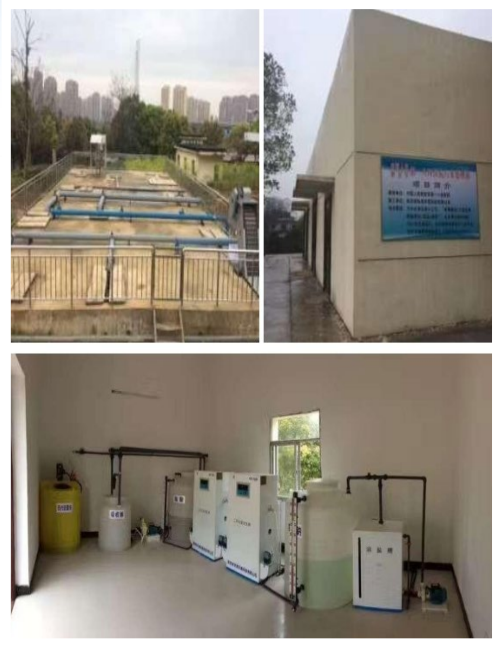
医疗废水处理项目
